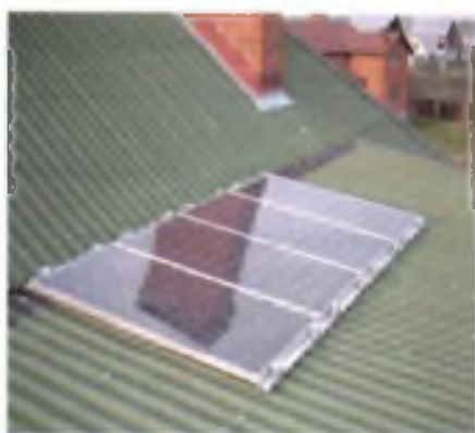
Рис. 162. Солнечная батарея на крыше дома
